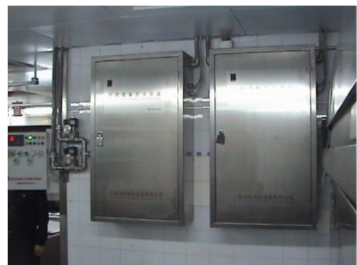
(图 2 厨房灭火系统灭火剂安放柜)
